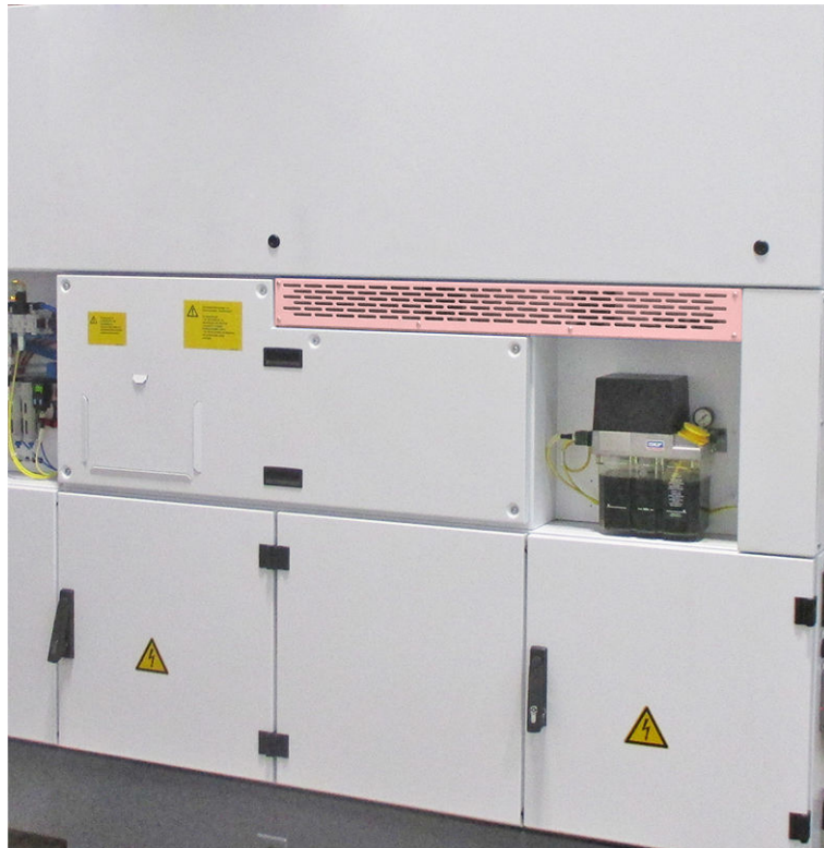
Beispiel: Lüfter Schaltschrank, TNL20
