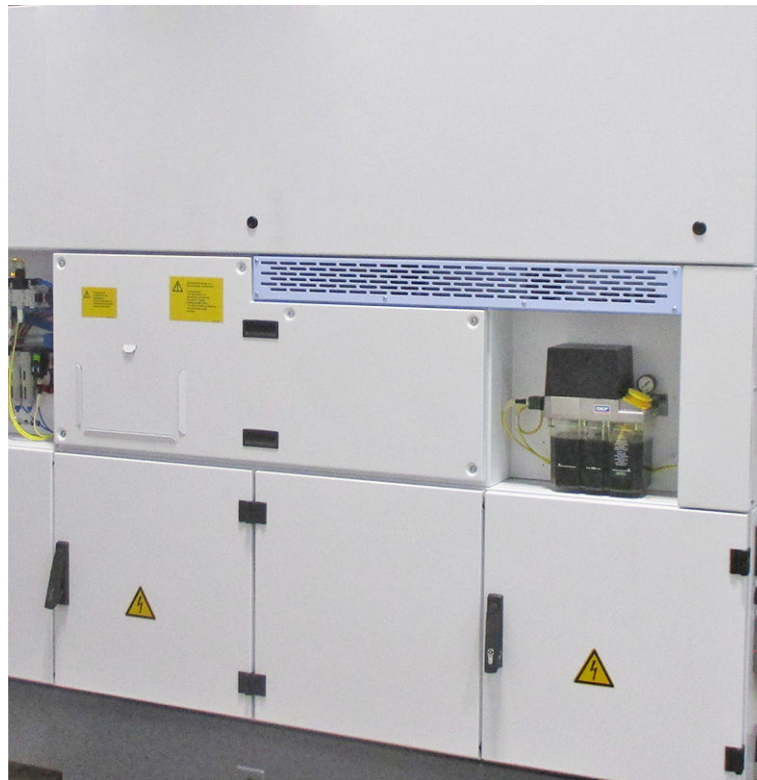
Armoire de commande_TNL20_Ventilateur_1
